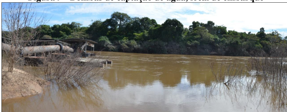
Figura 9 - Bombas de captação de água, local de embarque
